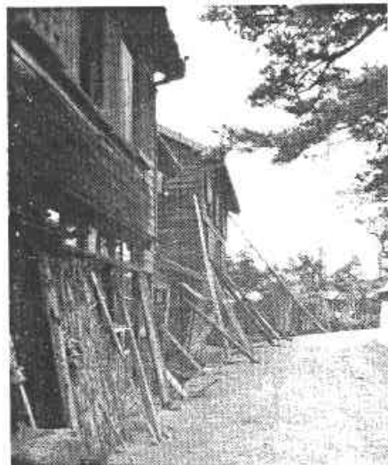
写真8 今にも倒れる原田精米製粉製めん工場。
